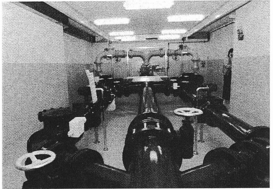
Blick in die unterirdische Druckerhöhungspumpstation «Ey» in Lattrigen (Leistung 2×6000 l/min, Förderhöhe 20–35 m).
